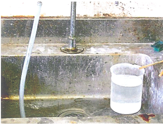
写真8. 流し台の腐食
