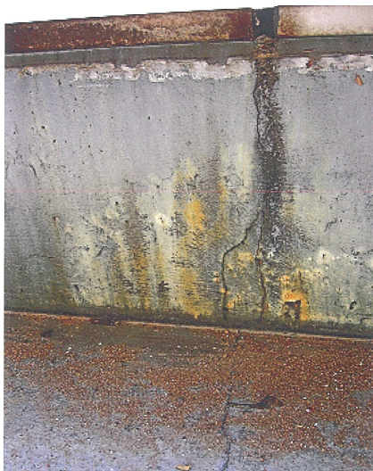
写真3. 2階から見た底部分の腐食
