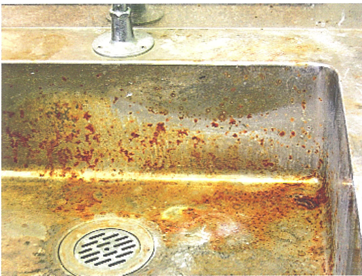
写真9. 流し台の腐食
