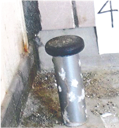
写真4．4階の非常階段のドア止め金具の腐食
