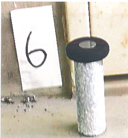
写真6．6階の非常階段のドア止め金具の腐食
