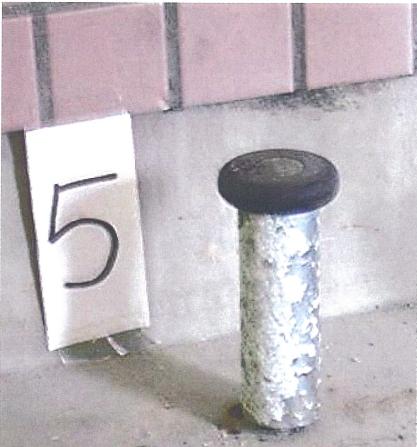
写真5．5階の非常階段のドア止め金具の腐食
